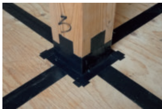
図資 7-5-22 柱下部が防湿気密フィルムを貫通する部分の施工例
