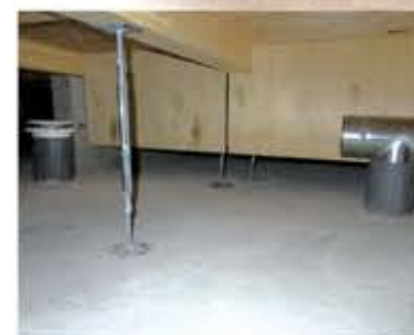
②床下側の給気口
